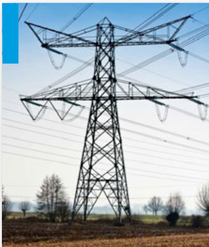
Figuur 13: Vakwerkmast HVAC 400 kV 2 x 2000 MVA (foto: TenneT)
