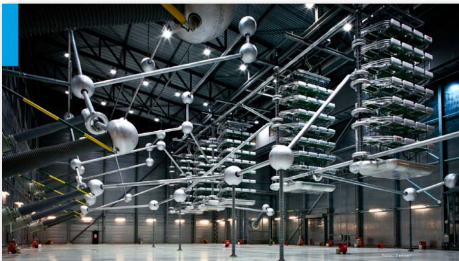
Figuur 18: NorNed HVDC converterinstallatie (foto: TenneT)
