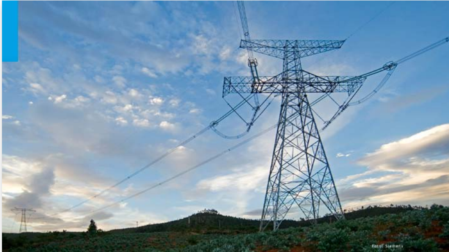
Figuur 14: Vakwerkmast 800 kV HVDC, China, 5000 MW (foto Siemens).
